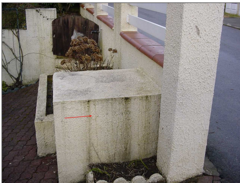
Photo n° 1 : Commune de Plaisance-du-Touch, quartier du Petit Castel (n° 16 rue des Rouges gorges). La photographie montre la hauteur de la crue sur le mur d'entrée (0,40 m). Le quartier du Petit Castel a été inondé à partir de 2 heures du matin le 05/02 par refoulement du réseau d'assainissement. Vers 2h30 la crue du Touch est passée par dessus les levées qui protègent le quartier.
